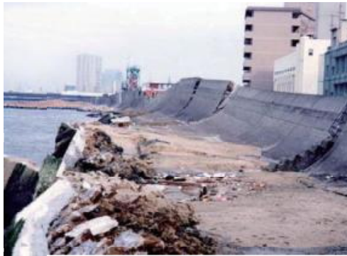
地震発生後の淀川の堤防
