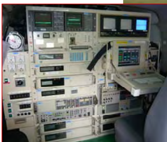
各種通信機器(衛星通信車内部)
