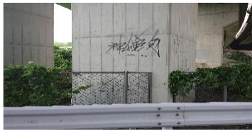
京滋バイパス宇治橋の左岸橋桁の落書き
