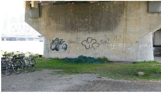
⑫ 新十三大橋橋脚 落書き
