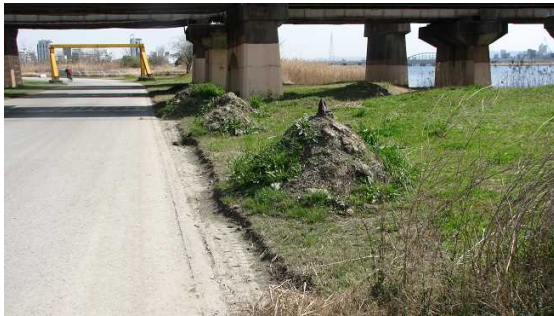
⑱ 阪急電車橋脚すぐのガードレール 落書き
