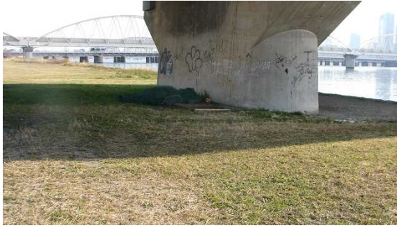
⑫ 新十三大橋橋脚に ネットと板材放置
