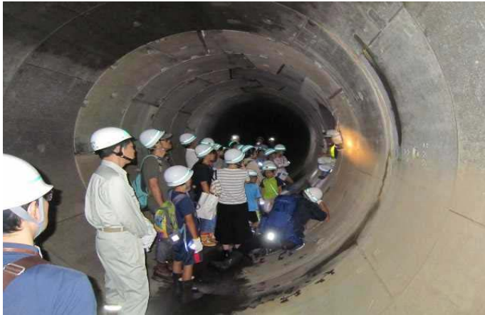
川からあふれる水を一時的に貯留する 雨水幹線(トンネル)
