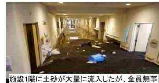
施設1階に土砂が大量に流入したが、全員無事 令和元年東日本台風 静岡県小山町における特別養護老人ホームの状況
