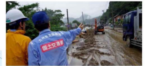
▲ 道路の被災調査
