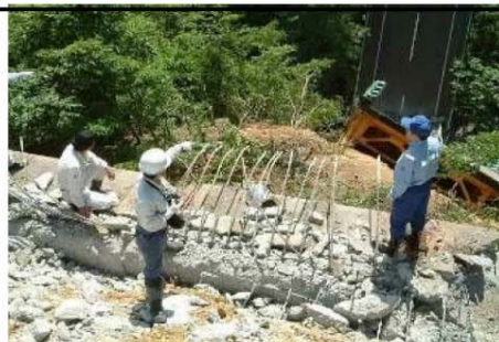
被災状況調査(現地調査)
