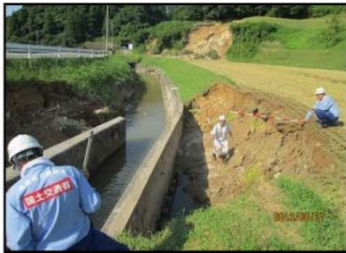
被災状況調査
