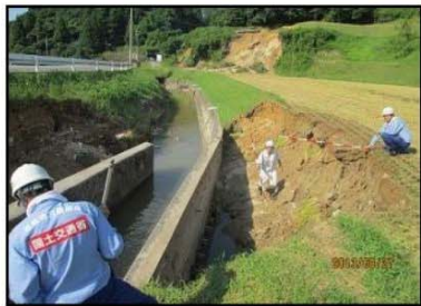
被災状況調査
