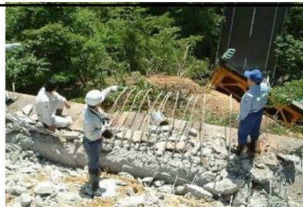
被災状況調査(現地調査)
