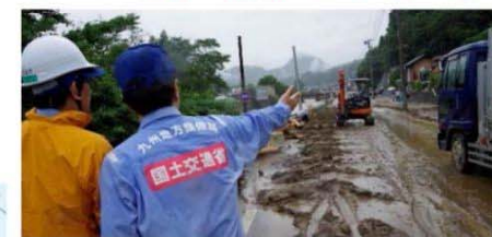
▲ 道路の被災調査
