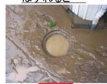
◇マンホールの蓋がはずれると...
