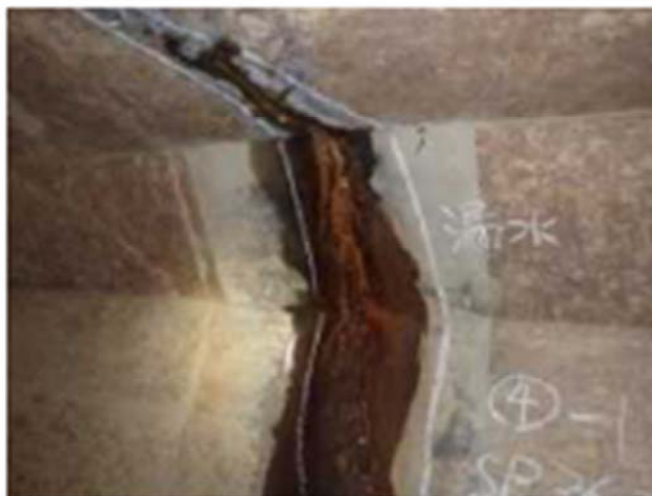
図 6.3.9 函内の漏水イメージ
