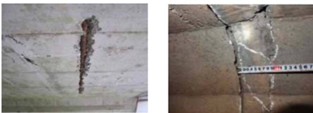
図 6.3.15 躯体の損傷事例
