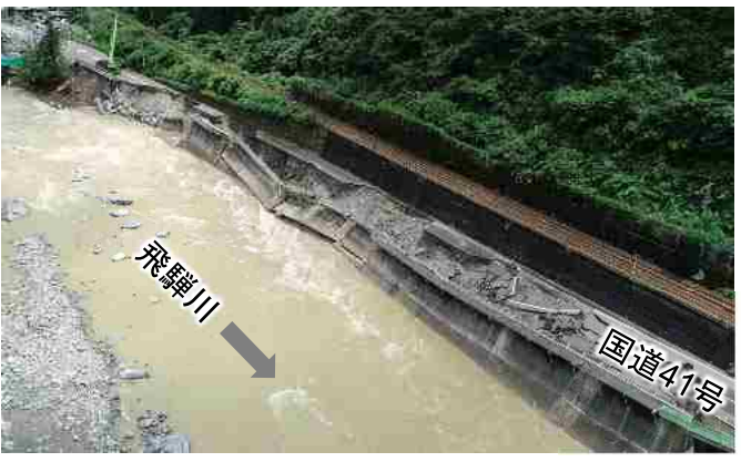
国道41号 道路崩壊 (岐阜県下呂市)
