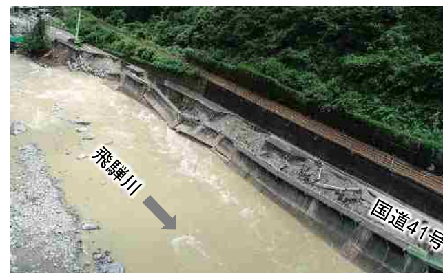
国道41号 道路崩壊 (岐阜県下呂市)
