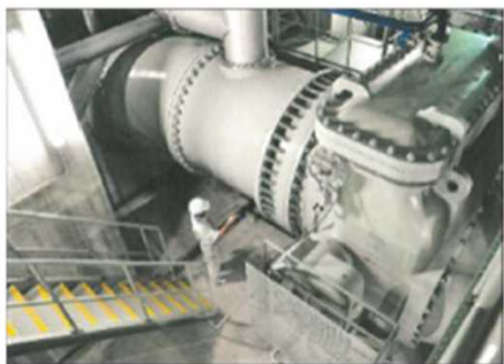
雨水ポンプの整備
