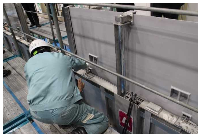
洪水時(止水壁起立)
