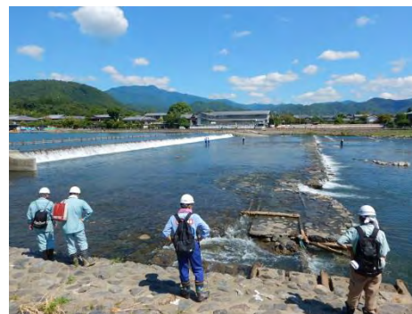
一の井堰護床工の被災状況確認
