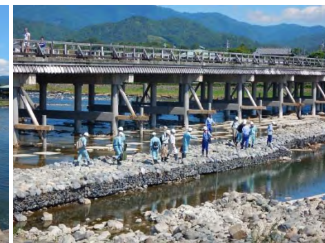
河床の洗掘状況の確認
