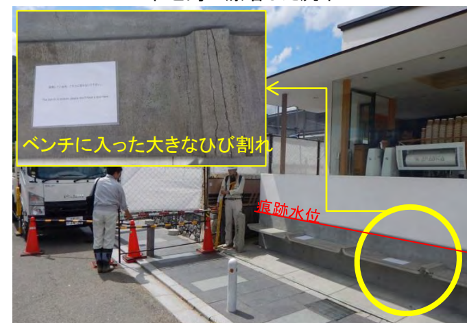
(H30.7月豪雨) 出水後の店舗施設(ベンチ)の損傷
