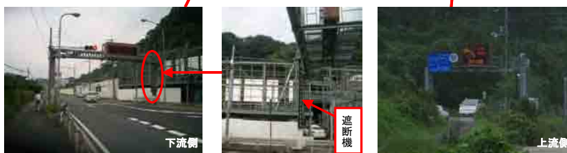
図 4.34 通行規制設備
