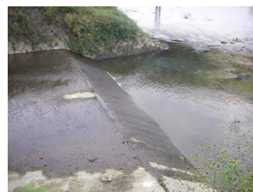
写真2.2 樋門樋管合流部の落差
