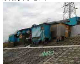
写真3.5 不法占用の状況
