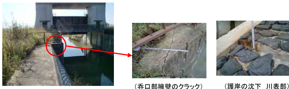
写真 4.10 モニタリング調査による変状確認(樋門の例)
