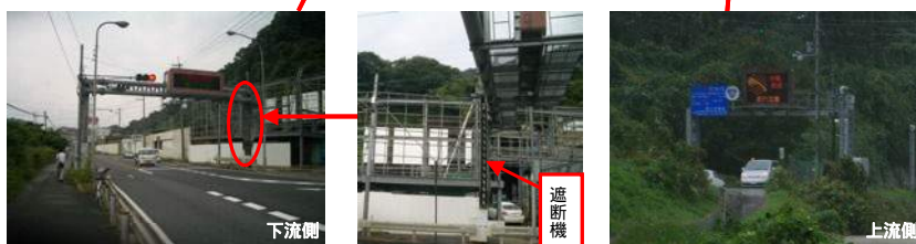
図 4.32 通行規制設備
