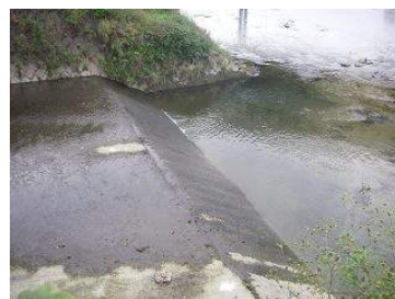
写真2.2 樋門樋管合流部の落差
