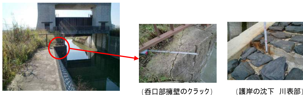
写真 4.8 モニタリング調査による変状確認 (樋門の例)
