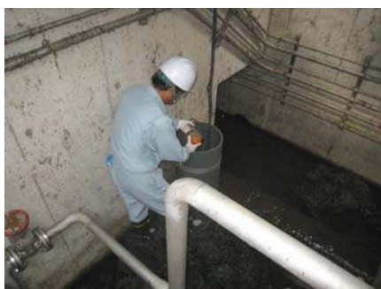
写真4.11 惣持寺樋門浄化施設の設備点検
