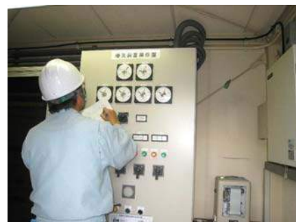
写真4.12 神南樋門浄化施設の設備点検
