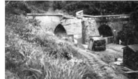
昭和 6～7 年の地すべり（国鉄関西本線の崩壊）
