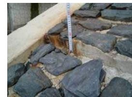
(護岸の沈下 川表部)
