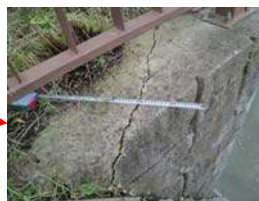
(呑口部擁壁のクラック)
