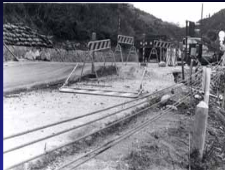
昭和42年の被災状況
