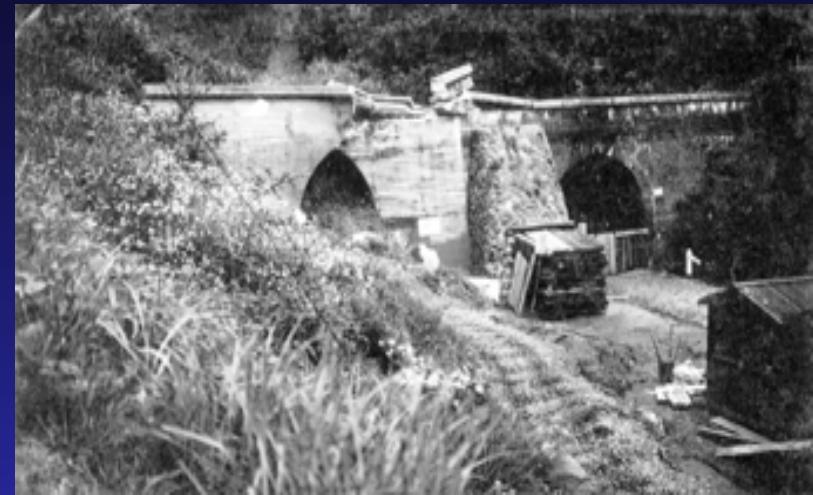
国鉄関西本線(現JR)亀の瀬トンネルの崩壊
