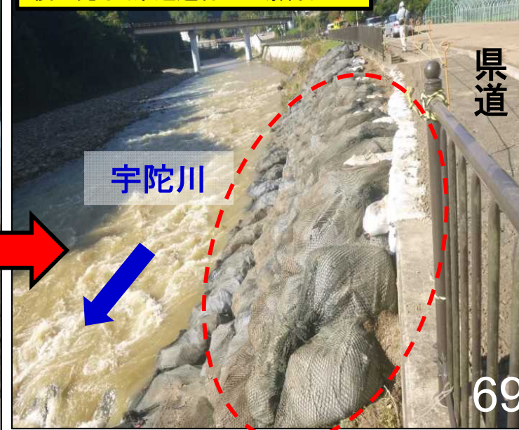
10/27 10:00頃 復旧完了(県道通行止め解除)
