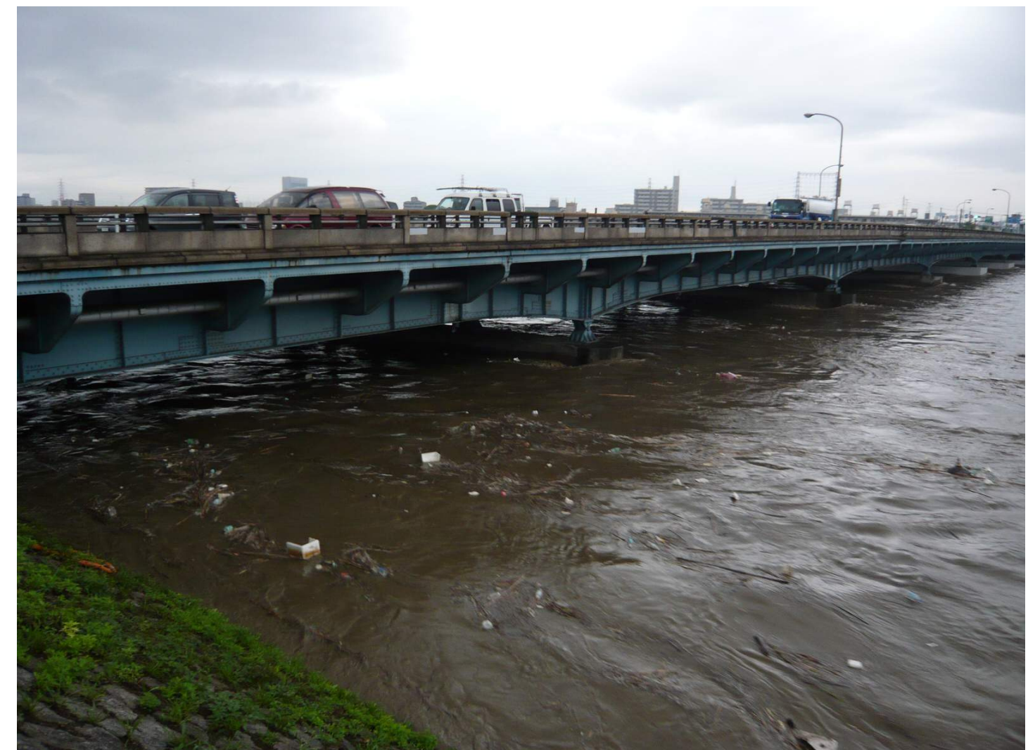
【7月17日5時40分 大和川大橋(3.2k+130m付近)】
