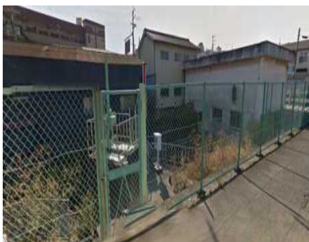
国分第1雨水ポンプ場
