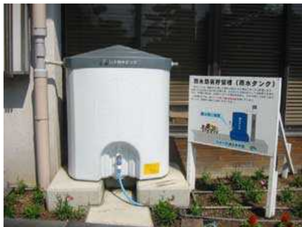
雨水タンク設置状況(市役所前)
