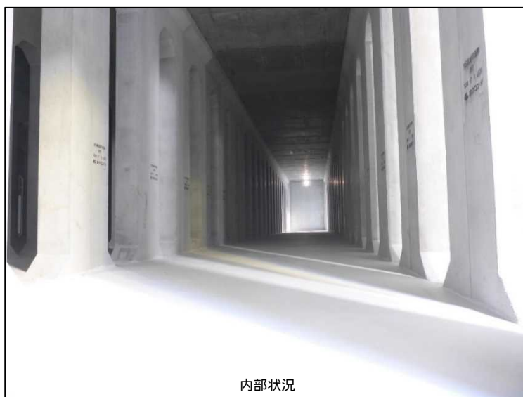
社会福祉協議会駐車場地下貯留施設 (貯留量 3,873m 3 )
