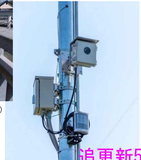
簡易型河川監視カメラ(設置例)
