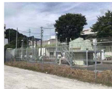
国分市場第1雨水ポンプ場
