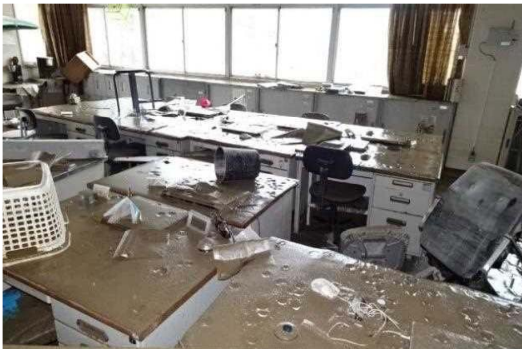
令和2年7月豪雨による学校の職員室の浸水被害
