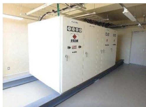
移設後の受変電設備
