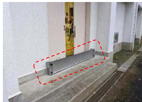
屋内運動場の出入口に設置した止水板
