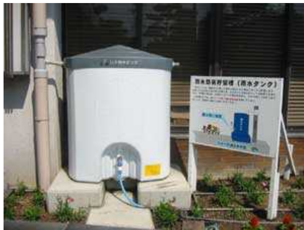
雨水タンク設置状況(市役所前)
