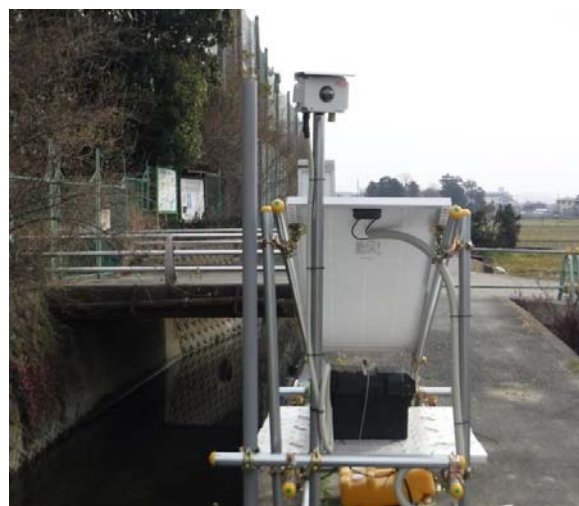
設置状況（カメラ）
