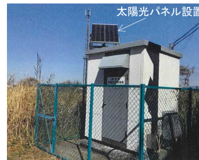
水位観測局 外観
