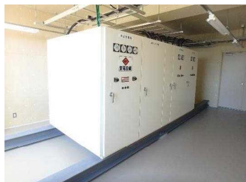
移設後の受変電設備
