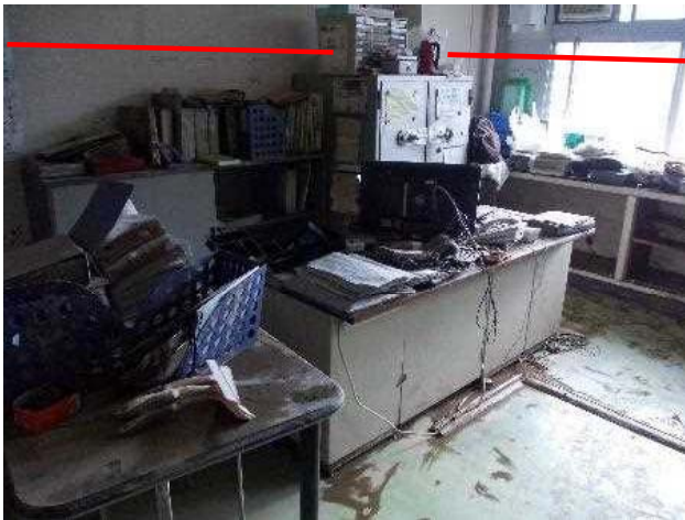
被災時の1階職員室 赤線：浸水高さ
