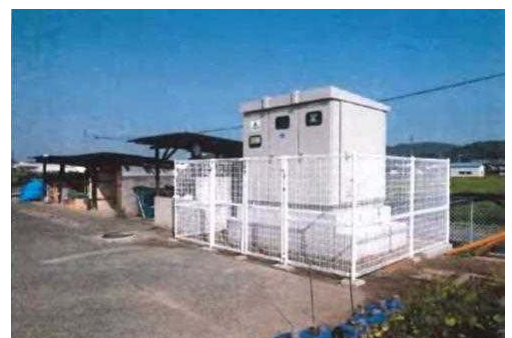
設置面を嵩上げたキュービクル式高圧受電設備
