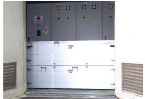
電気室内に設置した止水板
