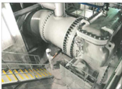
雨水ポンプの整備
