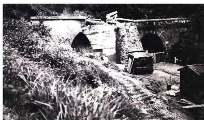
旧国鉄・関西本線トンネルの圧壊
