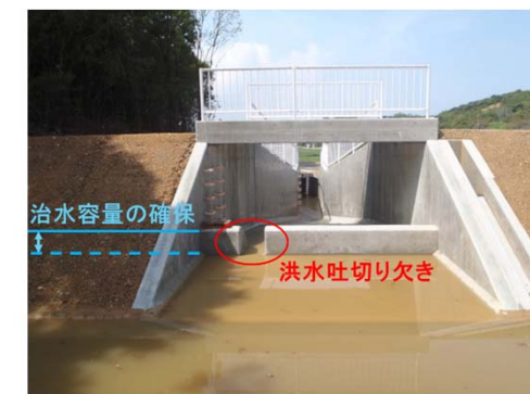
洪水吐切り欠きの設置により治水容量の確保を行った事例
