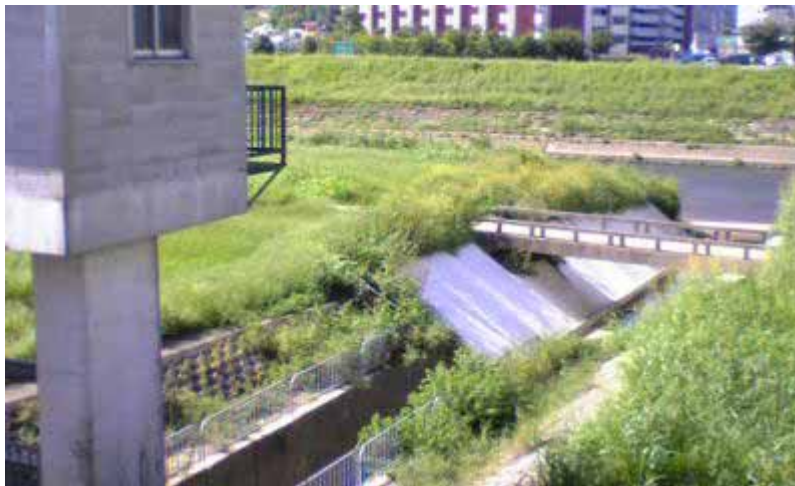
写真 久度樋門浄化施設(プラスチック製接触材による浄化、H19.3 完成) (堤外水路の左岸側の大和川高水敷の中に埋設)
