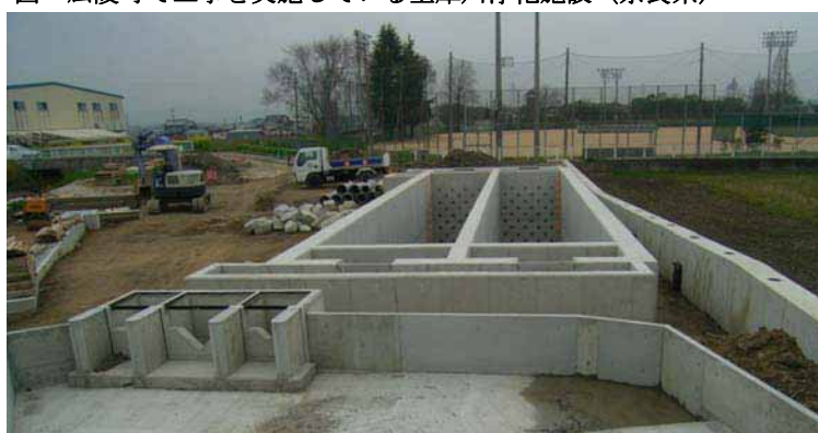
図 広陵町で工事を実施している土庫川浄化施設（奈良県）
