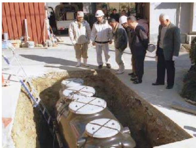
【高機能合併処理浄化槽の設置状況】
