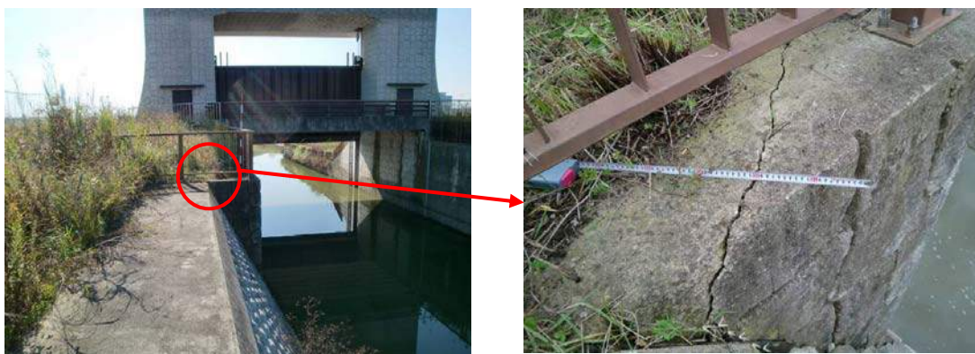
(呑口部擁壁のクラック)
