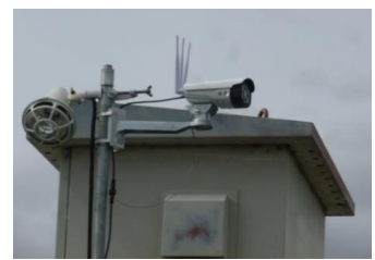
佐保川左岸4.8k（平和樋門）河川監視カメラ（簡易型）の設置状況
