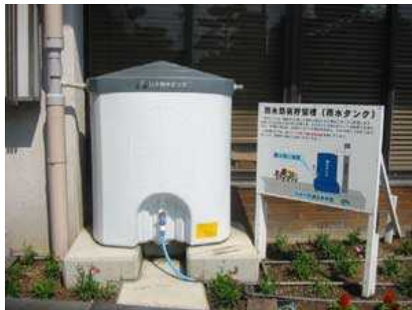
雨水タンク設置状況(市役所前)
