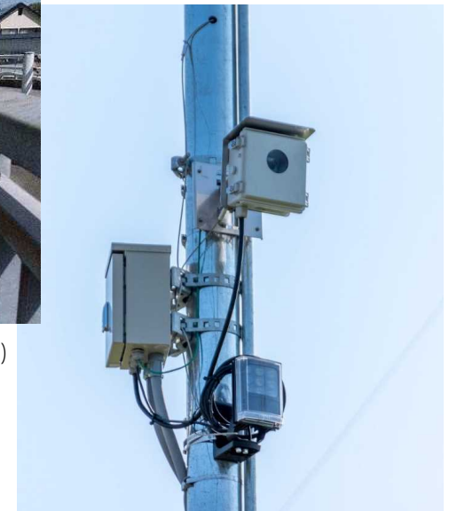
簡易型河川監視カメラ(設置例)
