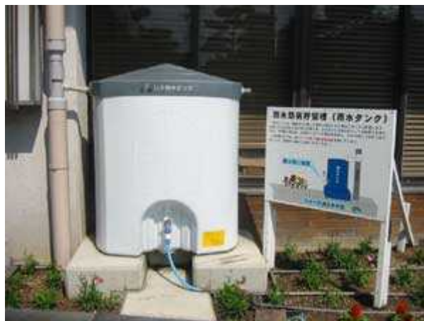
雨水タンク設置状況(市役所前)
