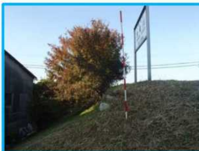
石積みの崩落
