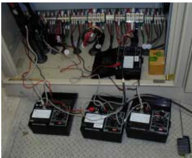
写真 3.7 電流・電圧計
