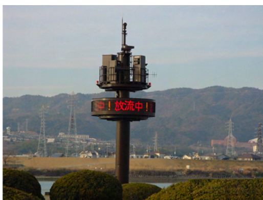
写真 4.4.6 紀の川大堰警報局及び電光表示板
