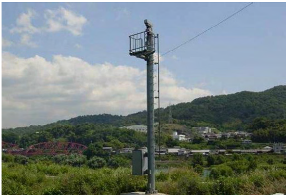
写真4.4.4 監視カメラの設置状況（右岸岩出橋付近）
