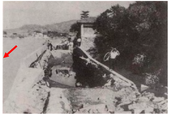
写真 1.2.2 県道海南九度山線：麻生津～竜門間の被害状況（昭和 28 年台風 13 号）
