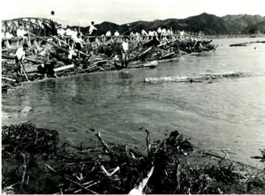
写真 1.2.3 和歌山市南海橋の被害状況 (昭和 34 年伊勢湾台風)
