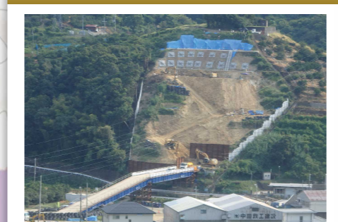
トンネル坑口付近の地すべり対策工事を進めています。
