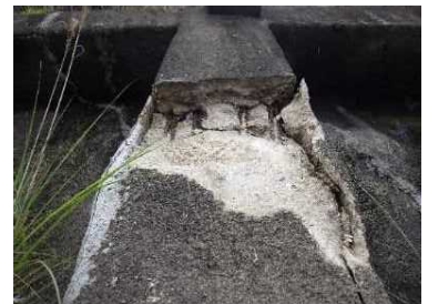
法枠工の老朽化損傷
