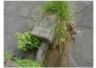
写真 アンカーの頭部からの湧水・雑草の繁茂の例
