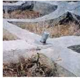
写真 受圧構造物の破損の例
