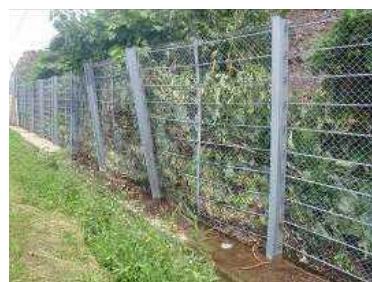
写真 落石防護柵の傾動の例
