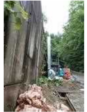
写真 壁面の傾斜の例
