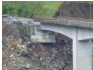
斜面変状による橋台の沈下
