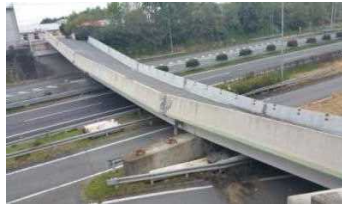
ロッキング橋脚を有する橋の落橋
