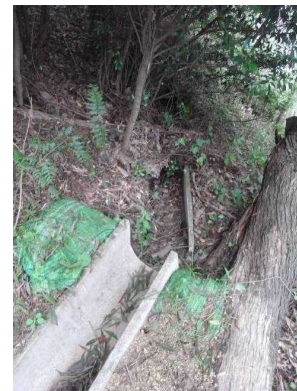
写真 排水溝の破損の例
