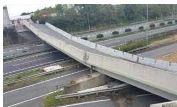
九州自動車道をまたぐ跨道橋の落橋 （県道小川嘉島線・府領第一橋）
